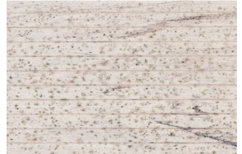
Stockflecken/Schimmel auf der Oberfläche
