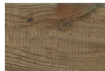
Raue Stellen auf der Holzoberfläche
