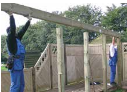
4 Sattelbalken auf Pfosten legen und verschrauben. Tipp: vorher Winkel zur Pfettenmontage befestigen. Danach Längskopfbänder anschrauben.
