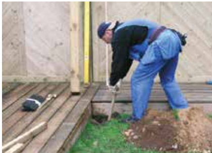
2 Erdarbeiten: Heben Sie Erdlöcher zur Aufnahme der Fundamente bzw. Pfosten aus – ggf. groben Kies in die Löcher einfüllen.
