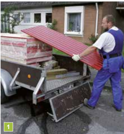
1 Der erste Schritt: Joda® empfiehlt, das folierte Bausatzpaket nach dem Auspacken gemäß beiliegender Bauanleitung zu sortieren.
