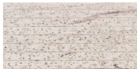
Stockflecken/Schimmel auf der Oberfläche
